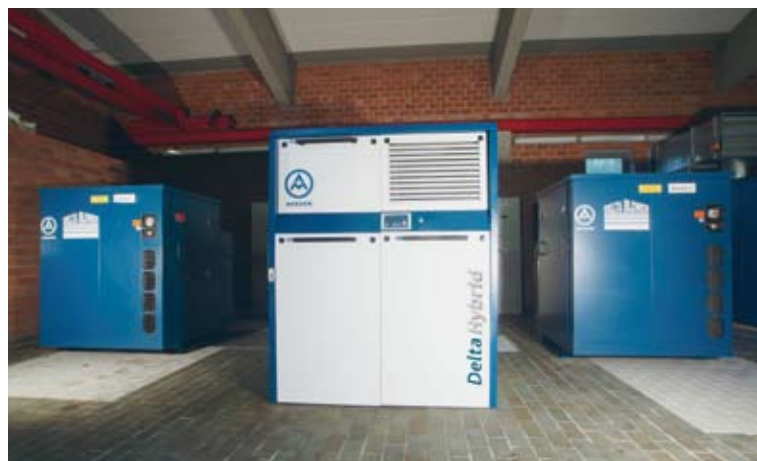
Станции очистки сточных вод в Бад Райхенхаль: 58 000 жителей, в эксплуатации с 2009 года.
