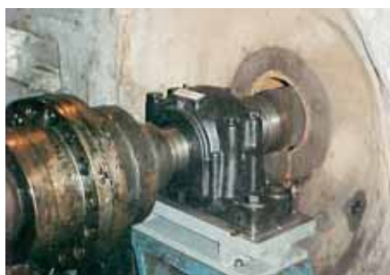
Подшипники в компрессорах и вентиляторах
