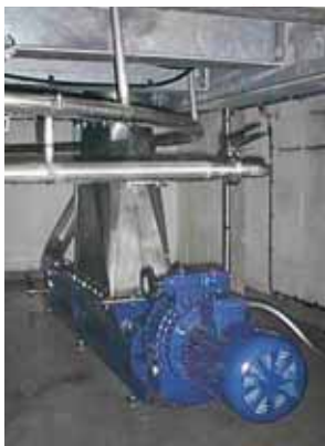
Насос seerex BT 17-12, продукт: затор суслу из заторного котла в фильтрационный чан, давление: 2 бар, производительность: 5 м 3 /ч
