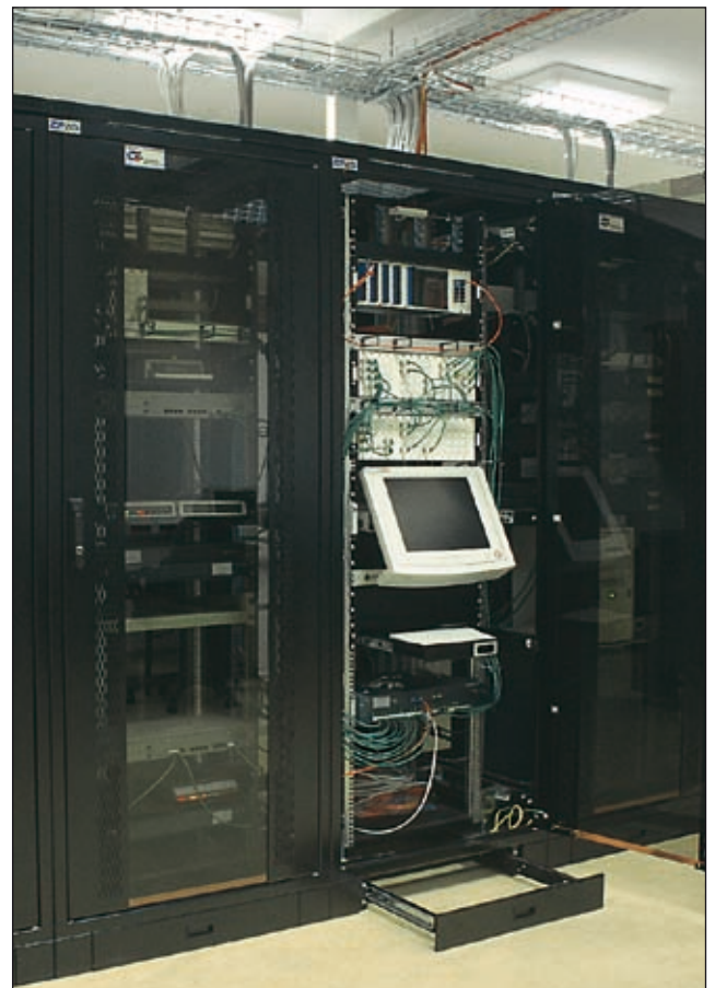
Серверное помещение смонтировано на базе шкафов производства ZPAS. Монтажные работы выполнило торгово-информационное предприятие ООО „MCP” из Кракова ( www.mcp.pl ).
