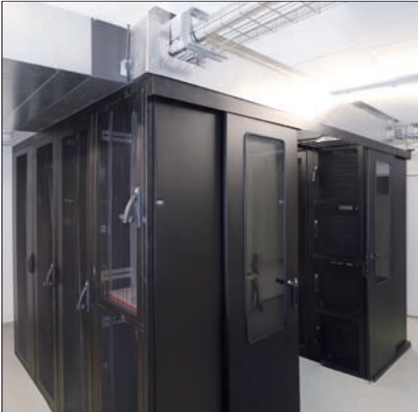
Серверный бокс, производства ZPAS, установлен в компании eM_I.T., Vad Ischl, Австрия
