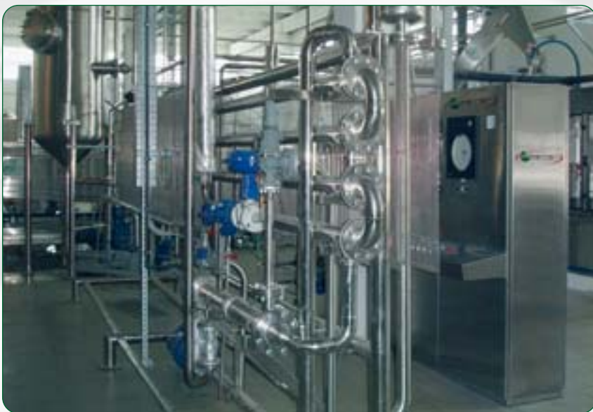
Pastorizzazione tubo in tubo. Pasteurizer pipe-in-pipe.
