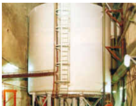
Отстойник ANDRITZ заглубленный в грунт
