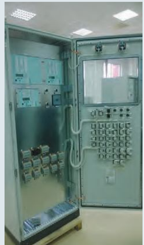
Рис. 4 Общий вид шкафа с микропроцессорным устройством «ЭКРА» и блоками
