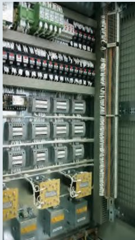
Рис. 3 Внутренняя часть шкафа с блоками FAME 6/6+1 и измерительными клеммами PTU 4-МТ-Р и PTU 6-Т-Р
