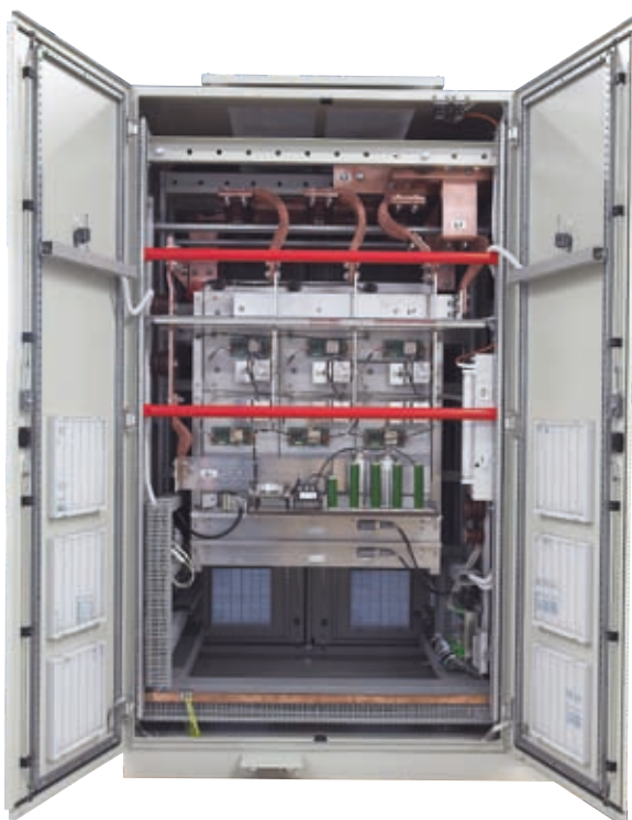
Шкафы возбуждения генератора – поле выпремителя
