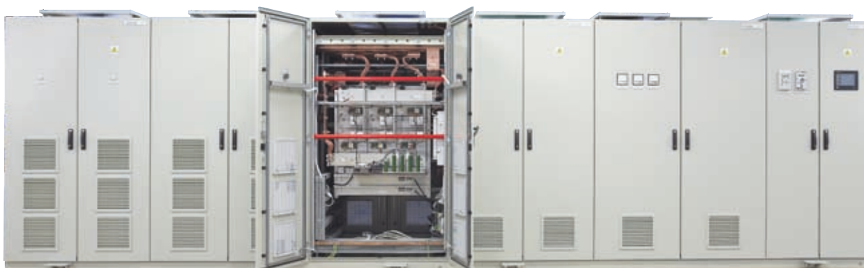
Шкафы возбуждения генератора 600 MW
