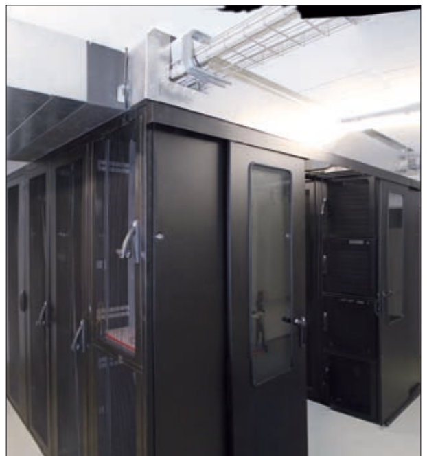
Серверный бокс, производства ZPAS, установлен в компании eM_I.T., Bad Ischl, Австрия
