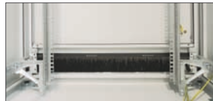
Панель 3 U установлена в шкафу шириной 800 мм
