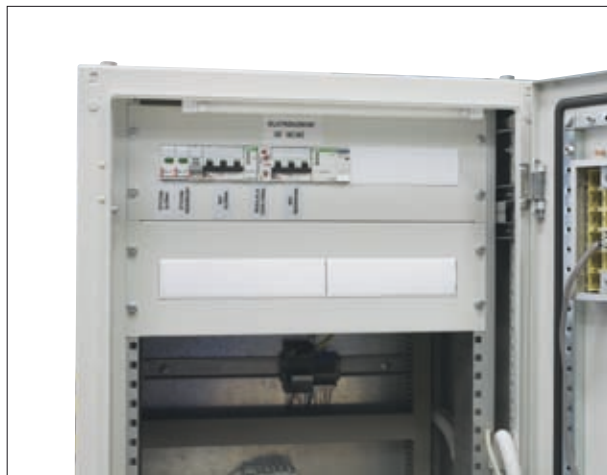
Релейная система АВР вмонтирована в шкаф
