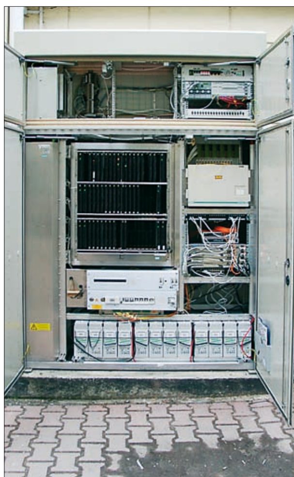
Шкаф после реконструкции
