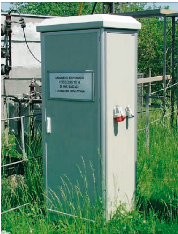
Шкаф дополнительного заземления для электроподстанции
