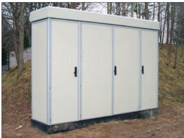
Шкаф после реконструкции
