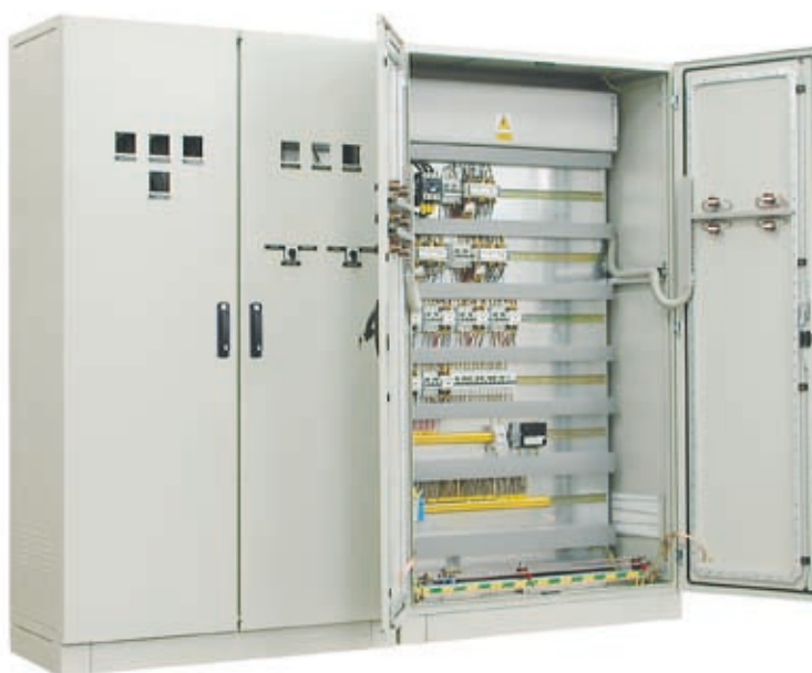
Распределительный щит среднего напряжения
