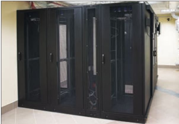
Бокс ЦОД, производства ZPAS, установленный на электростанции Gorzów
