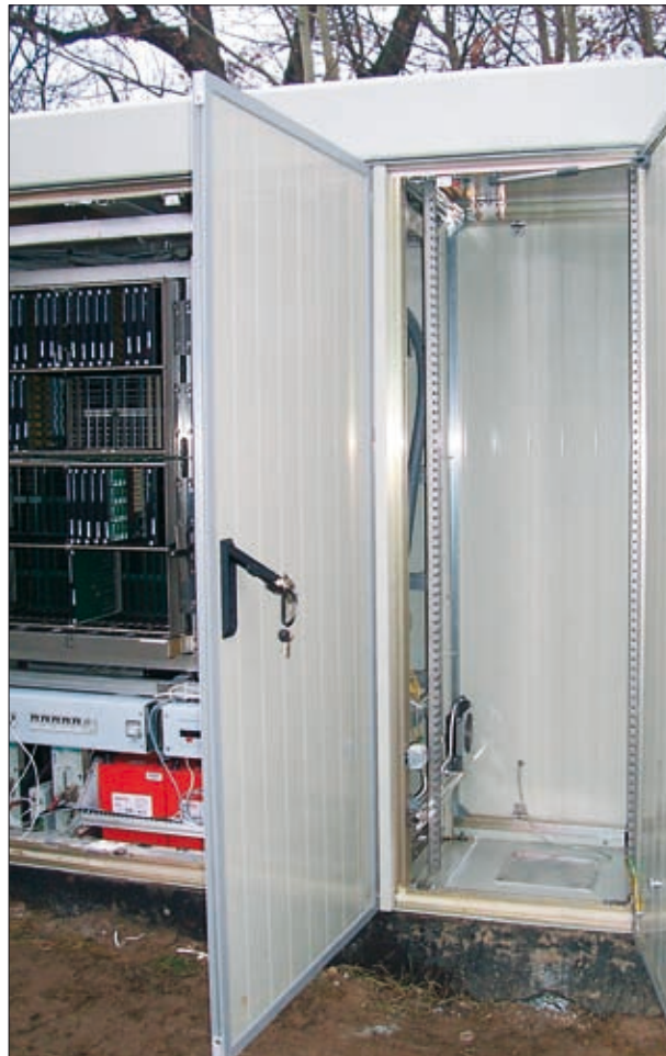
Шкаф после реконструкции
