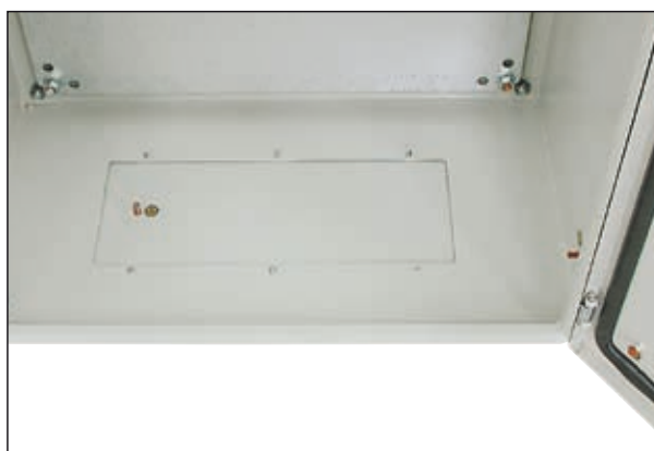
Заглушка, установленная в дне шкафа
