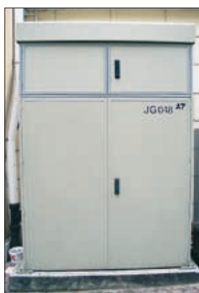
Шкаф после реконструкции
