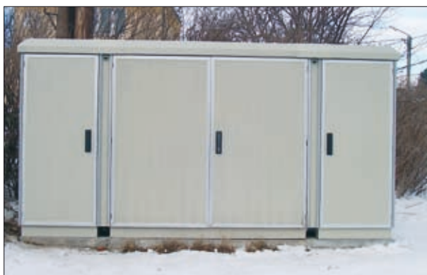
Шкаф после реконструкции
