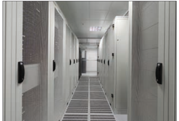
Шкафы DC, установленные в серверном помещении фирмы ATM S.A. в Варшаве
